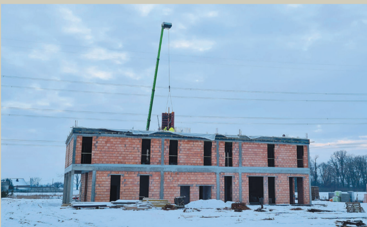
Roboty żelbetonowe i murowe związane z konstrukcją I i II piętra budynku
